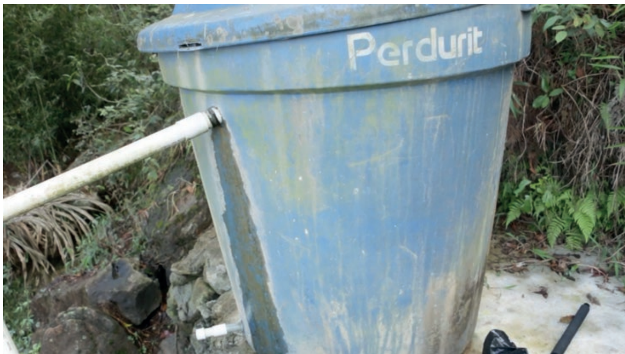
Figura 4. Tanque de acueducto comunitario. Fotografía: Dimekia Audiovisual
